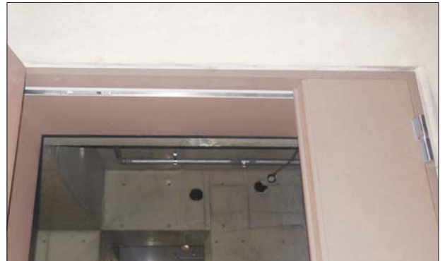
CRD-1 子扉が先に閉まった状態
