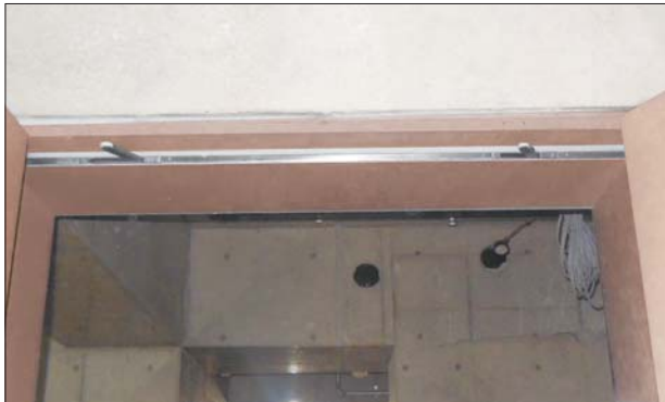
CRD-1 親扉・子扉が開いた状態
